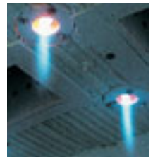
Deckenbefeuerung mit BIC-Brennern
