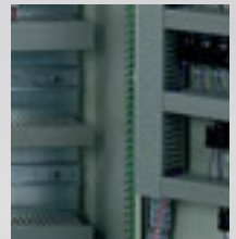
Automatisierungs- technik im Schaltschrank
